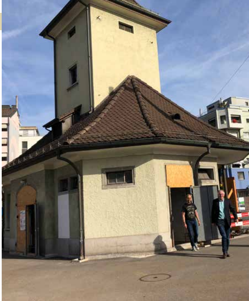
Für die Bauarbeiten geöffnet: Tramhüsli-Stiftungspräsident Urs Rudolf (rechts) und Architekt Hardi Bisig
